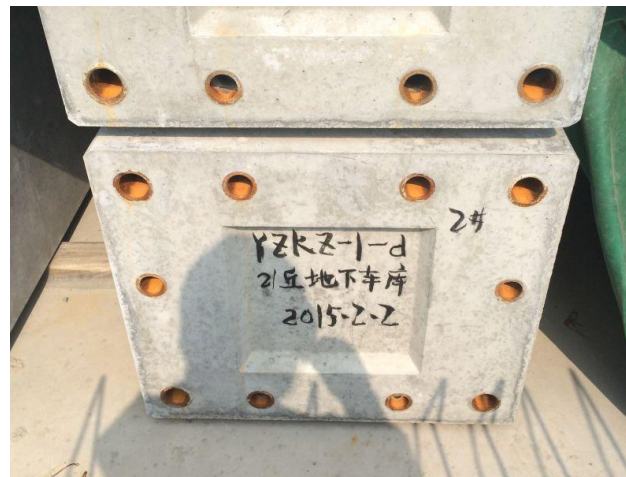
柱底键槽排气孔遗漏
